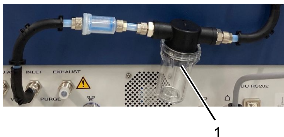
Obr. 10: Kontrola odlučovače kapaliny
