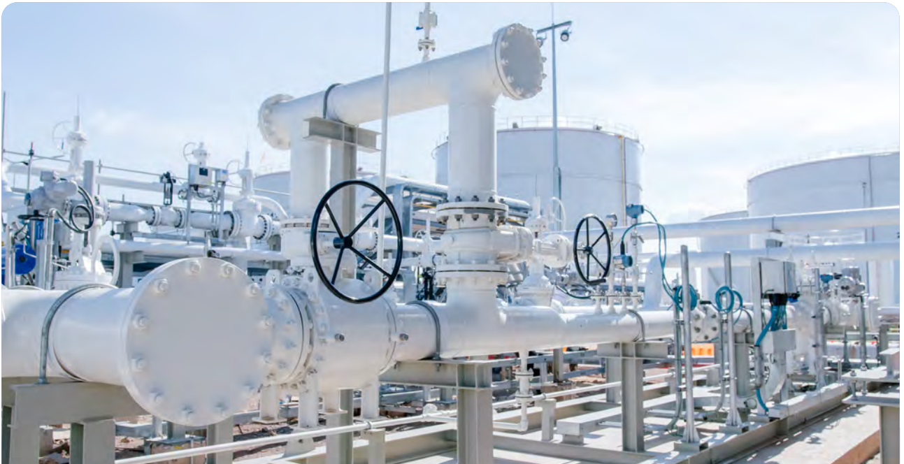
天然气行业必须监测供气网的天然气排放。
